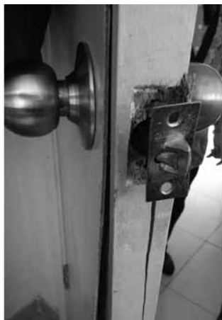
破損的門鎖，不能如常關門及鎖門。 Broken lock makes the door insecure.
